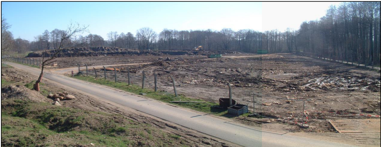
Abbildung 37: Ehemalige Deponie Burg
